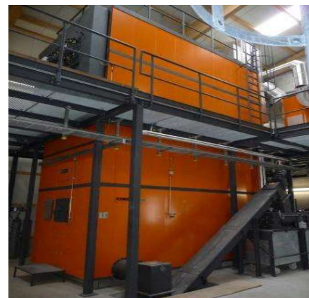
Heizkessel mit einer Leistung von 3,2 MW
