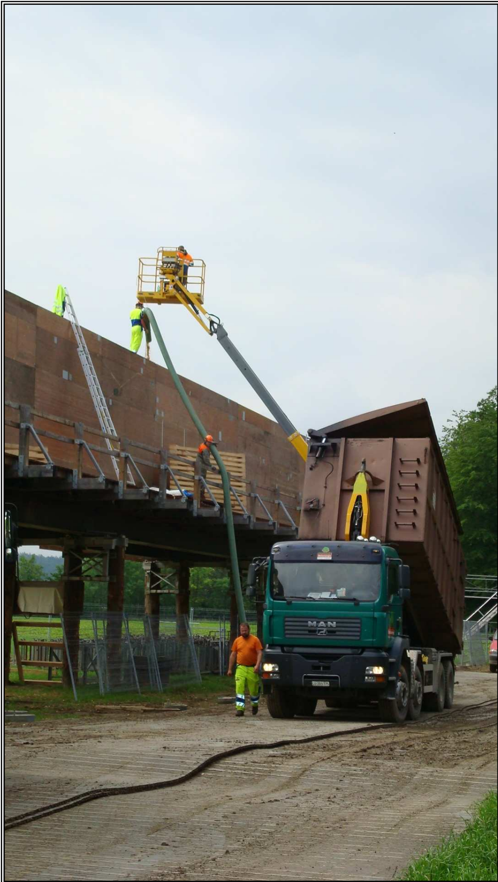
Die Höhe des Kugelfanges beträgt zum Teil über 9 Meter – kein Problem für den Woodjet.
